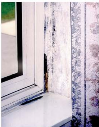
Schimmelpilzbefall in der Fensterlaibung
