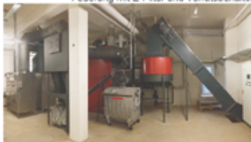
Anlagenbeispiel: autom. Vorschubrost-Feuerung mit E-Filter und Vorratsbehälter
