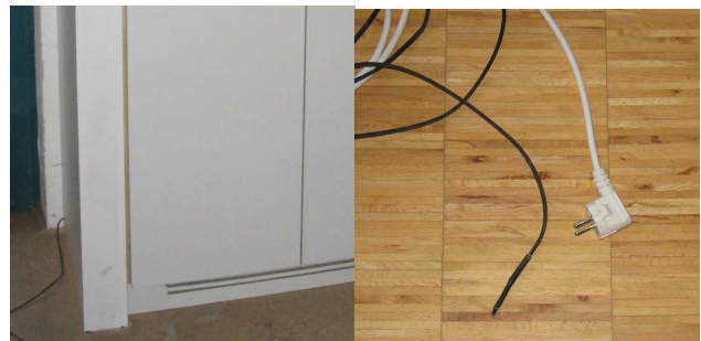
Abb.: Heizkabel mit 15 W/m hinter dem Schrank in Versuchsreihe untersucht Quelle: Peter Musch
